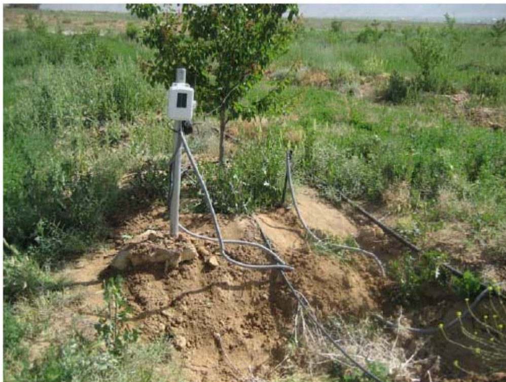
Instalación de los sensores de humedad del suelo
